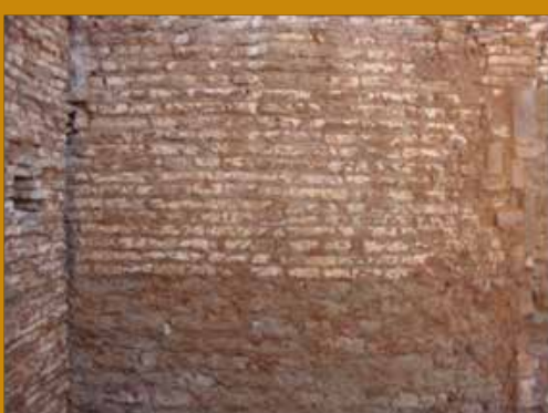
Fig. 4.13.d. Muro lado Este de la Sacristía Norte.
