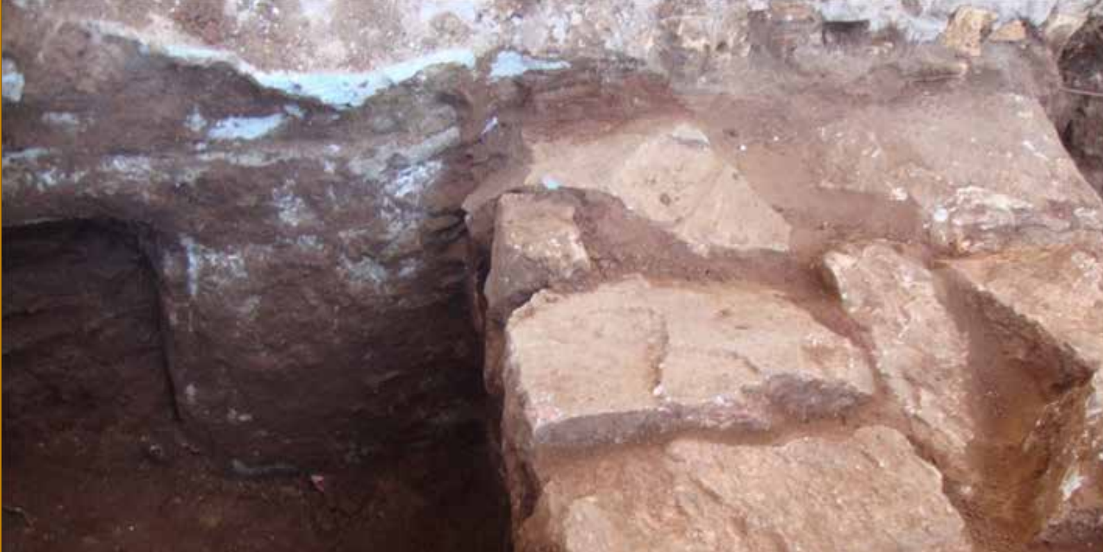
Figura 4.20. Muro de la fundación de la Iglesia Primitiva, donde se puede observar la intrusión de otro tipo de material de construcción, que es el hormigón y nivelación (1929), soportando la pared de mampostería del frente de la Iglesia actual.
